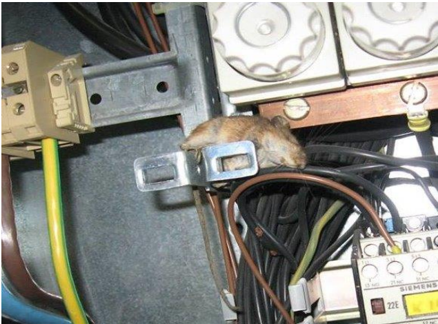
Bildquelle Armin Wölk: Durch Stromschlag verwendete Maus in einer Niederspannungsanlage
