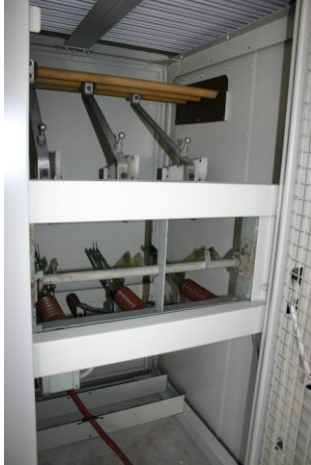
Blick in die Schaltanlage / Bildquelle: Franz Swoboda
