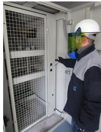
Öffnen der Gittertüre der Schaltanlage Bildquelle: Franz Swoboda
