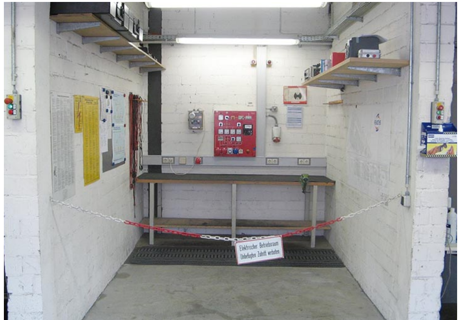
Vorbildlich ausgestatteter Prüfplatz in der Elektrowerkstatt
