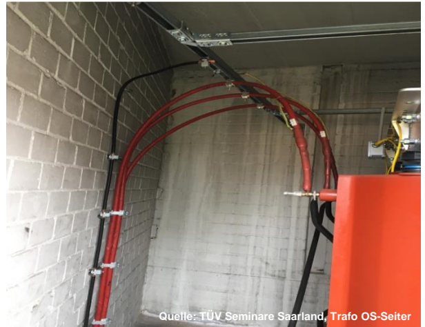
Quelle: TÜV Seminare Saarland, Trafo OS-Seiter
